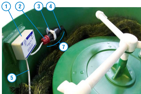
Вид 2. Внутренняя сторона биореактора Станции. Установленное электрооборудование Станции
